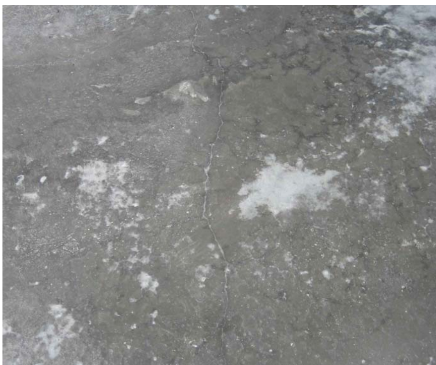
Figur 8:8. Spricka i del av betonggolv som inte innehåller krympningsreducerare.
