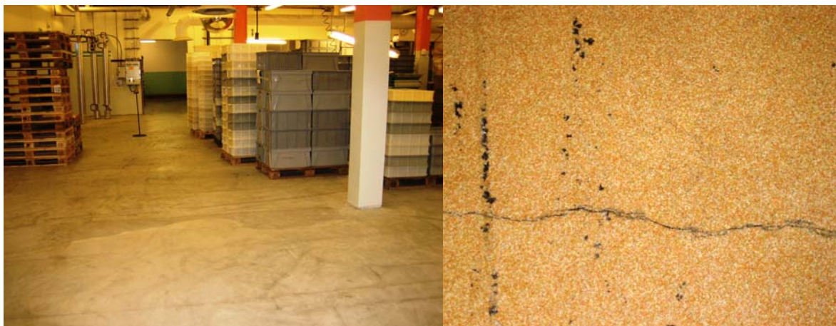
Figur 8:1a, Nygjuten yta (ytbeläggning kommer att läggas på. b. Tidigare förstärkning med krympspricka i golv.
